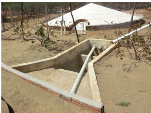
Foto 18 - Cisterna utilizada para captação de água da chuva
